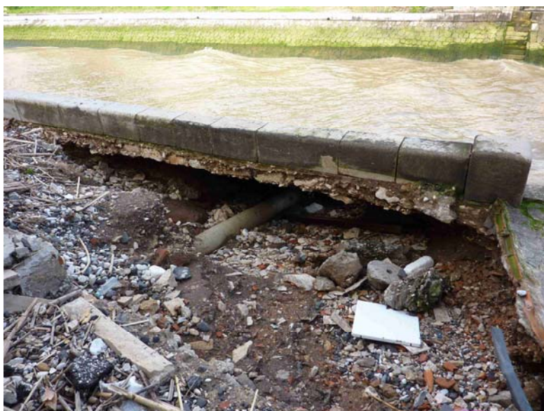
Fotografia 8 – Erosão do leito de cheias na margem direita do rio Jamor entre a ponte da Av. Marginal e a ponte da REFER (vista para montante).
