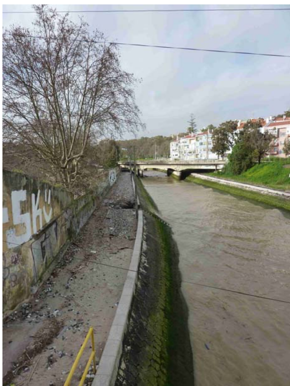
Fotografia 7 – Leito de cheias na margem direita do rio Jamor entre a ponte da Av. Marginal e a ponte da REFER (vista para montante).
